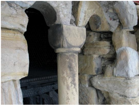
Rundbogenöffnungen im obersten Turmgeschoß (Glockenstube), gekuppelte Bögen über einer Säule mit Würfelkapitell. Deutlich zu erkennen: das marode Turmmauerwerk.
